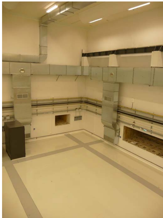
Vue de la zone LPA switchyard, avec passages pour les faisceaux vers les salles d'expérience
