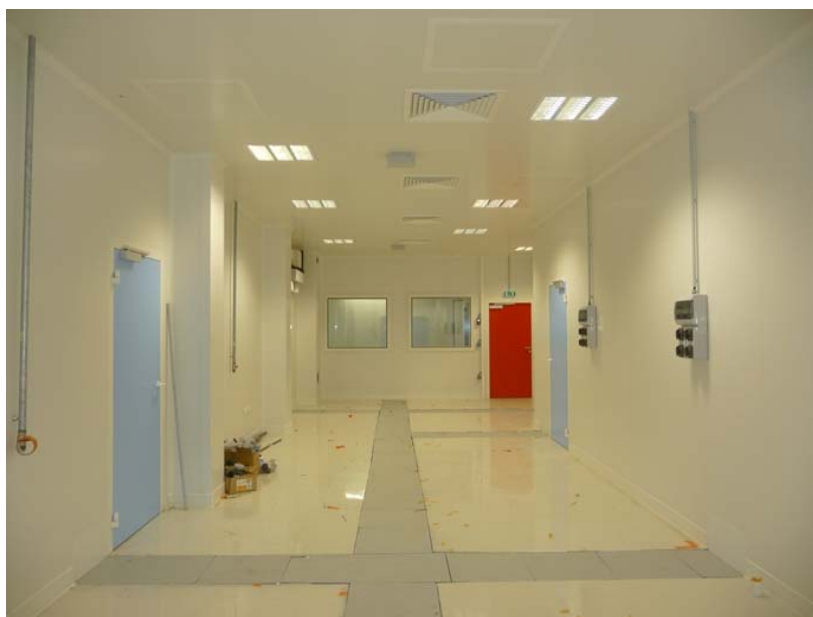
Vue de la salle Pilote (classe ISO 7), dite zone LPI
