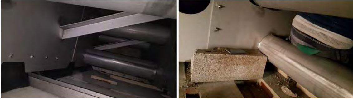
Vue de l'intérieur de meurtrière et à droite on aperçoit le maçon en train de réaliser un mur en merlon.
