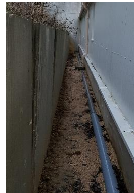
Vue du pianotement des blocs bétons de soutènement de la terre de remblais
